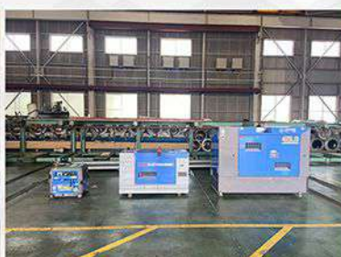
発電機の確保
